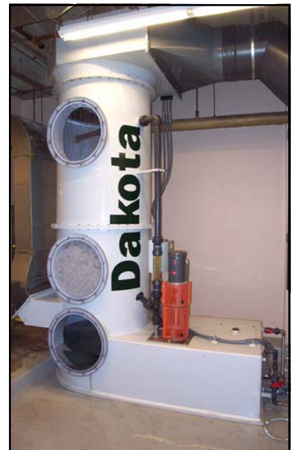
Dakota Scrubber™ para Ashland Casting Solutions Laboratorio De Servicio Técnico Proceso de Uret- hano De Caja Fría
